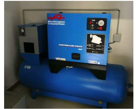
Compresseur de détassage de CAG
