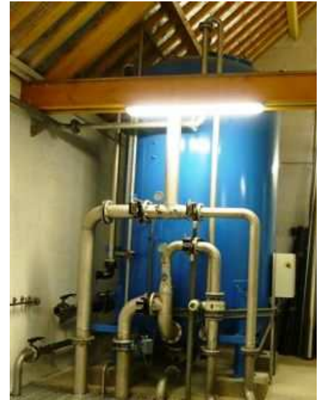
Cuve de traitement à CAG
