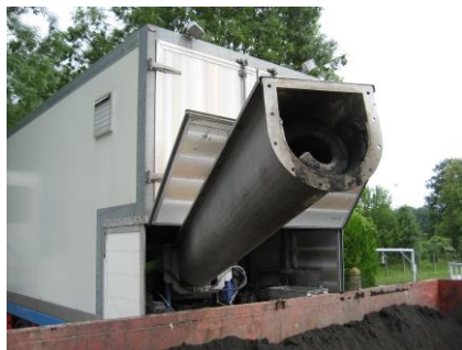
Unité mobile de déshydratation des boues (Intervention sur les boues de lagunage de Meigneux)
